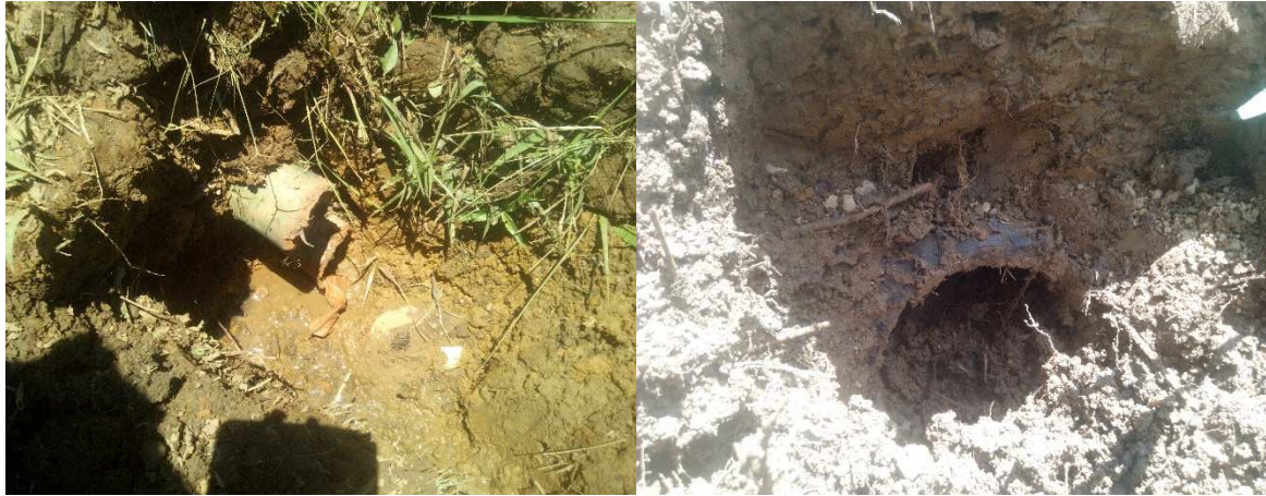
Figure 15: Photos de deux systèmes de vidanges en bambous placés sous la digue aval de l'étang barrage
