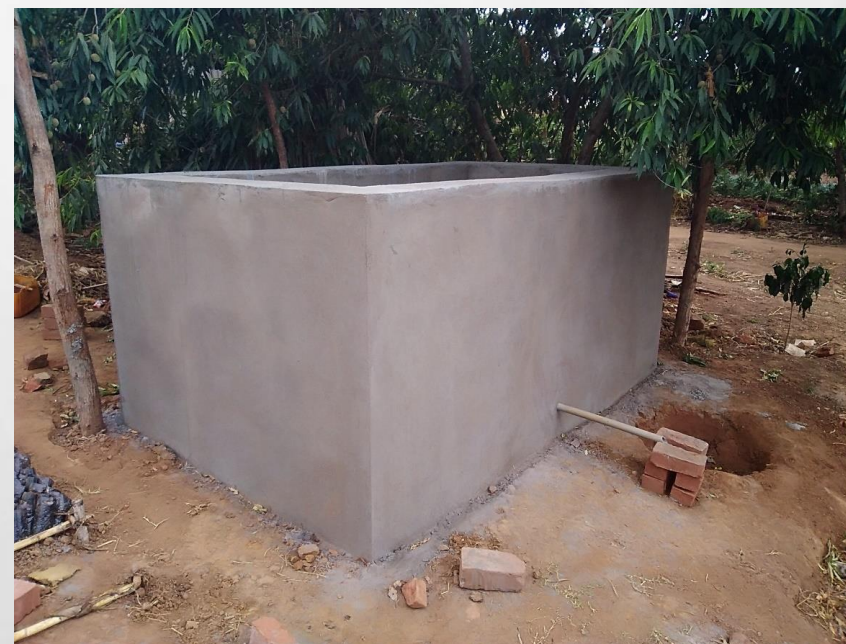
AUGMENTATION DE LA CAPACITÉ DE PRODUCTION, AVEC BASSIN DE 2 M3
