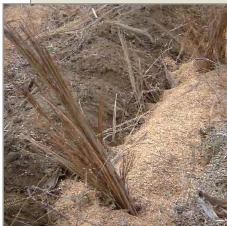
Remplissage des tranchées avec le combustible et confection de cheminées Photo : K. Naudin
